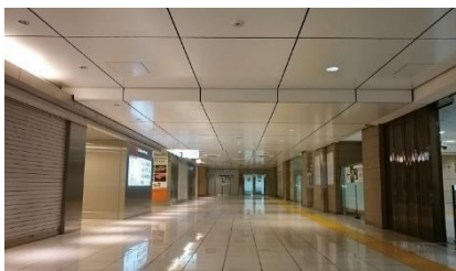
⑥ 天井パネル (JR東京駅キッチンストリート)
